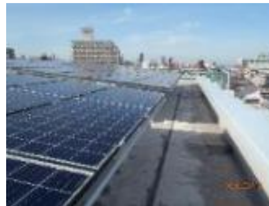
太陽光パネル
